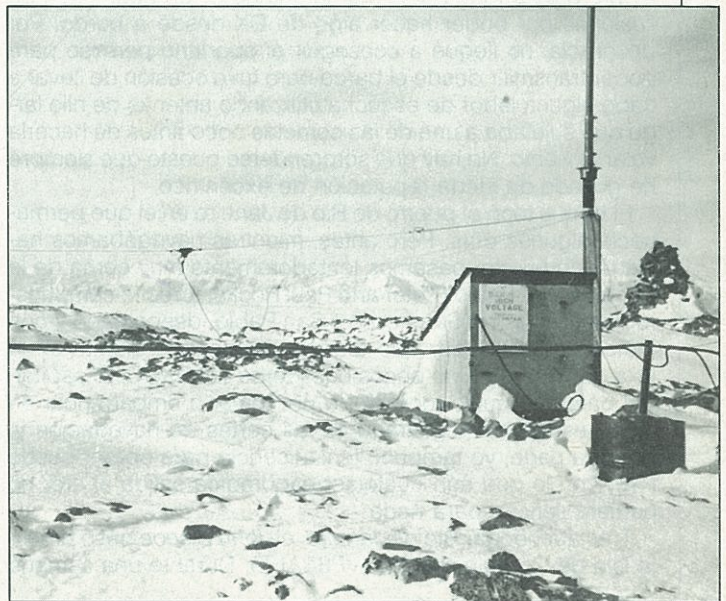
La antena de la radiobaliza de 10 m y la caseta que da cobijo al equipo.
