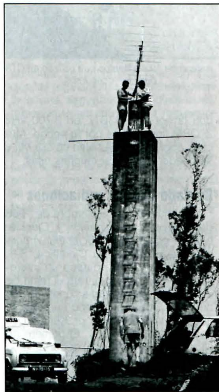
Instalación de la antena de CT3DK. La «torreta» no está nada mal.
