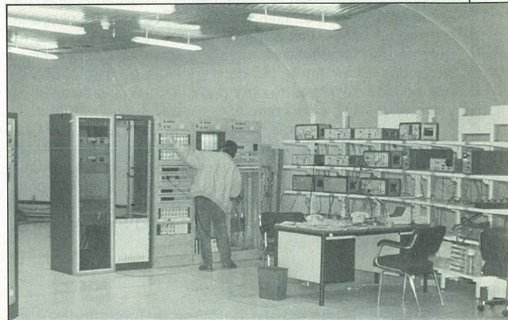
Equipos de los radioenlaces privados de algunas empresas comerciales. En la Torre trabajan quince personas al cuidado de las instalaciones.
