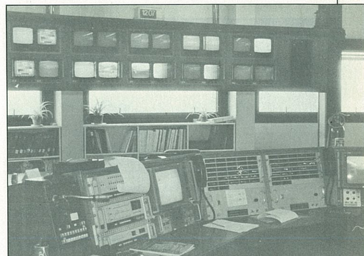
Pupitre de comando de la Torre. Una matriz de 32 vías facilita la conexión de cualquier fuente de señal a cualquier emisor.
