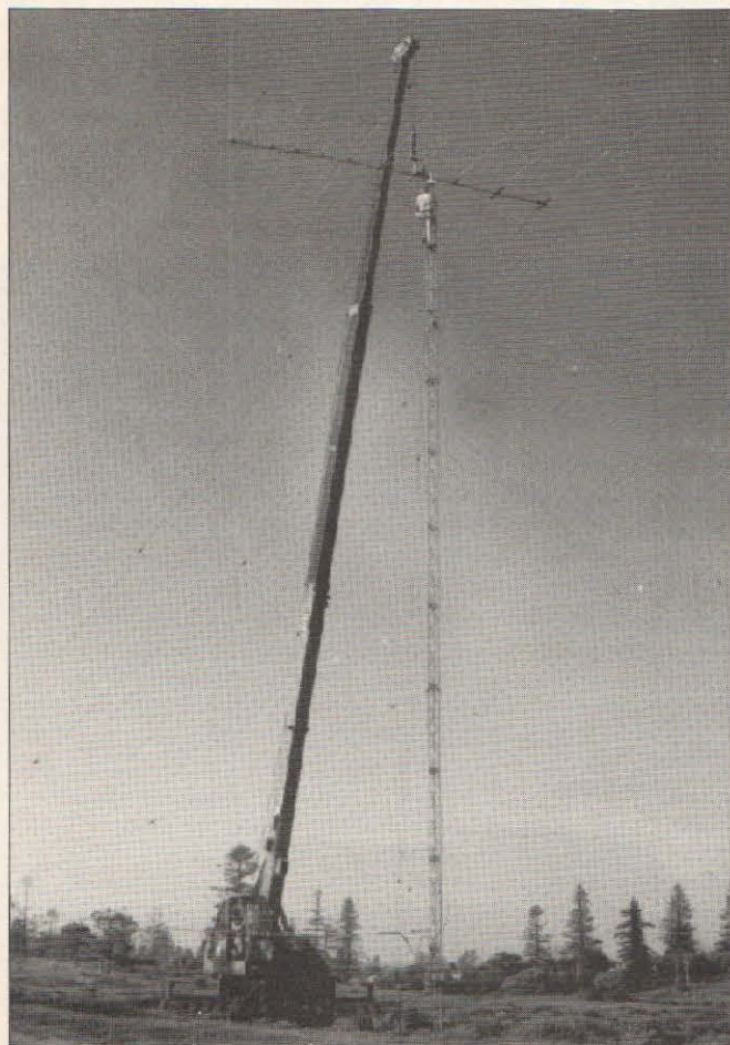
No puedo evitar mostrar esta fotografía. Jim Smith, VK9NS, de la isla Norfolk, sabe muy bien como instalar una «log periodic».
