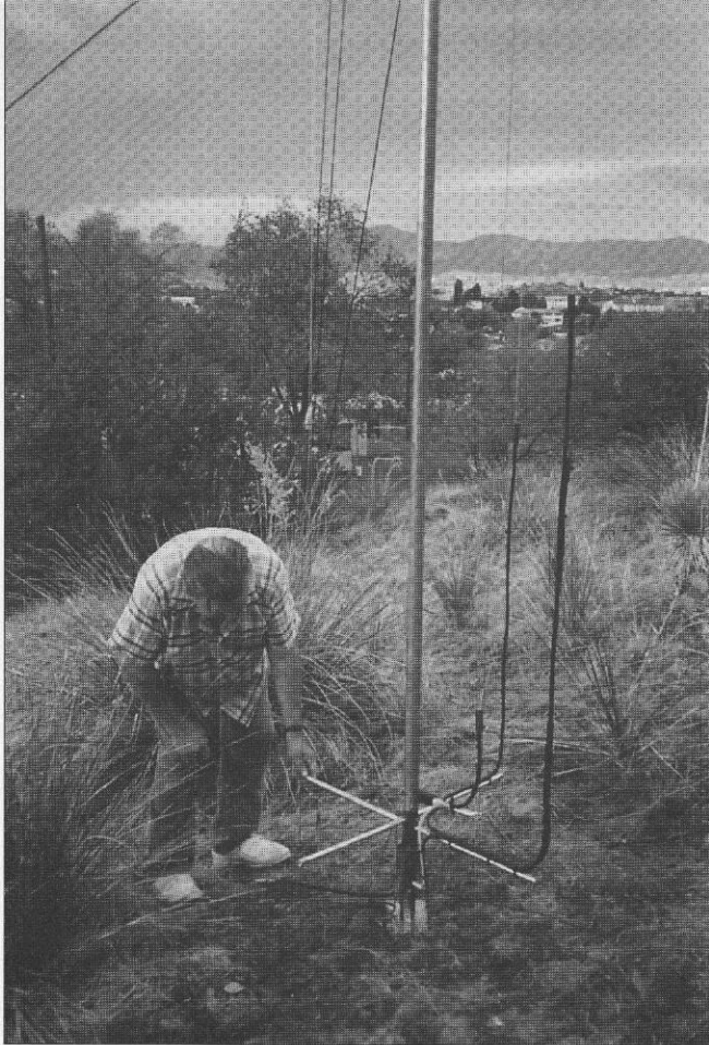
He aquí a W1ICP examinando la estructura de alimentación de la antena Uni-Hat. Invisibles, hay 6 radiales de 9 m.
