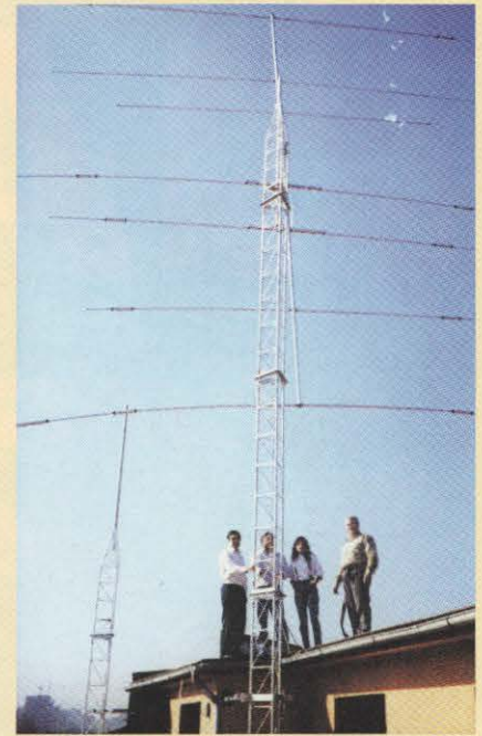
En la cubierta del edificio de Monte Igueldo, instalando las antenas, sobre las torretas Sirmatt.
