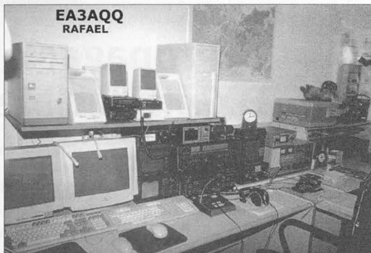
Un buen ejemplo de cuarto de radio con gran cantidad de equipos.
