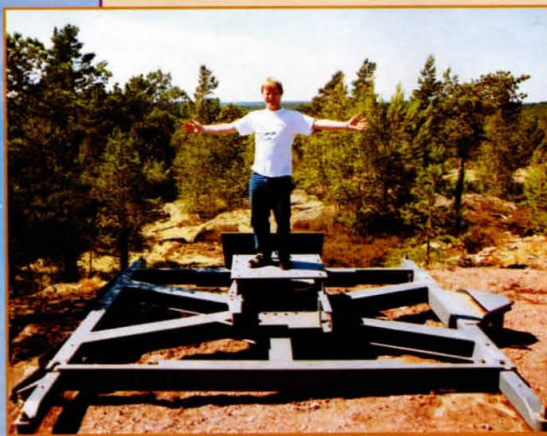
Esto es la base para una nueva torre giratoria, en la que el año próximo se instalarán antenas apiladas para VHF y UHF y acaso alguna para HF.
