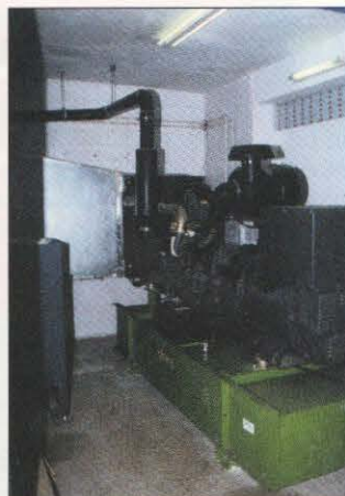
Un grupo generador eléctrico permite mantener los servicios esenciales en caso de fallo en el suministro de energía.
