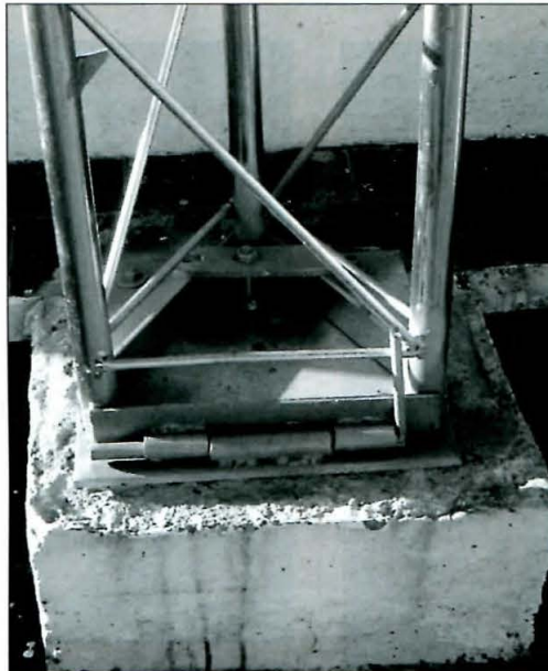
Detalle de la base de la torre, con la bisagra que permite abatirla.
