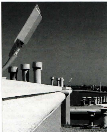
Una instalación de antena direccional. Nótese el ángulo de montaje horizontal, conocido como «down tilt», que se utiliza para centrar el lóbulo principal de la antena sobre el área a servir y no sobre el horizonte, reduciendo así la interferencia a otras áreas, lo que en el caso de la fotografía es importante, ya que más de 15 puntos de acceso sirven a esta comunidad. (Fotografías del autor).
