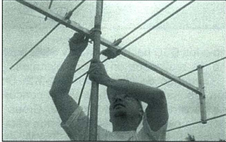
PY20C instalando la antena para recepción de la banda comercial de FM.
