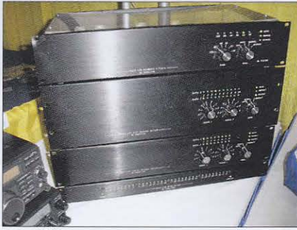
Foto D. Los equipos de control que forman Shack-LAN: filtros paso banda, conmutadores de antena, interfaces transceptor/commutador de antena y un controlador de relés, todos interconectados mediante una red Ethernet convencional.
