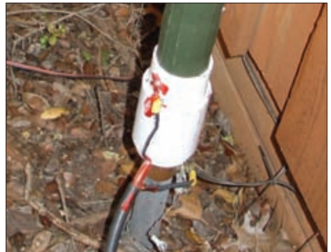
Foto D. Aislador de tubo de PVC en la base de la antena.
