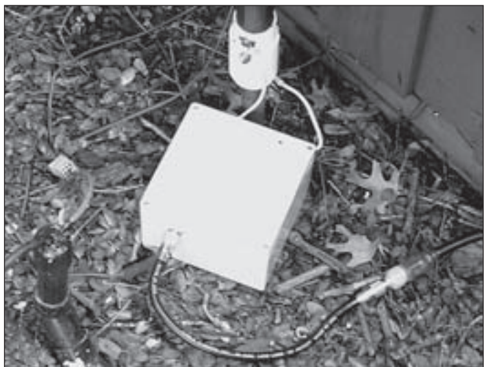
Foto B. La caja adaptadora instalada en la base de la antena vertical de 11 metros de altura.
