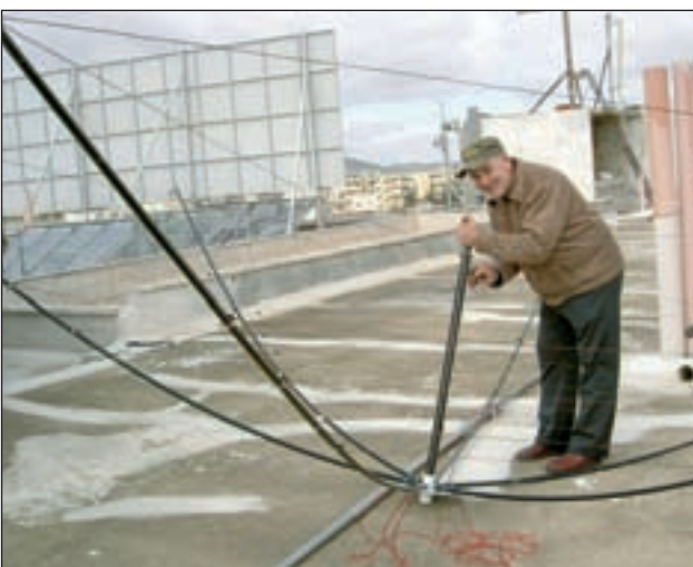
Les, SP3D0I en la terraza del hotel montando la Spiderbeam para 10, 12, 15, 17 y 20 metros, que luego habría que mudar de emplazamiento tratando de reducir el QRM de los ascensores.
