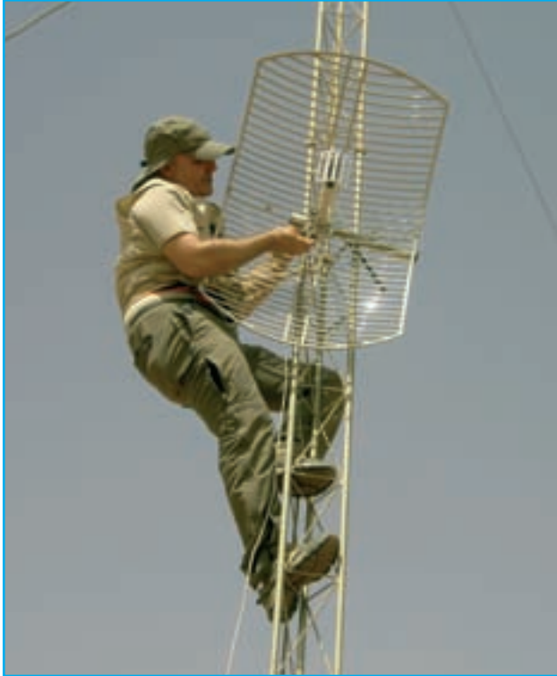
Foto F. La torreta existente fue de utilidad para mejorar el alcance del enlace WiFi. EA5XQ, en una incómoda postura, ajustando la antena.
