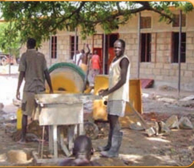
Vista del progreso de la construcción en la escuela media para chicas de Rumbeck, Sur del Sudán. La Orden de Malta y el equipo de 1A3A impulsaron el avance del proyecto. (Foto cedida por la web de 1A3A).
