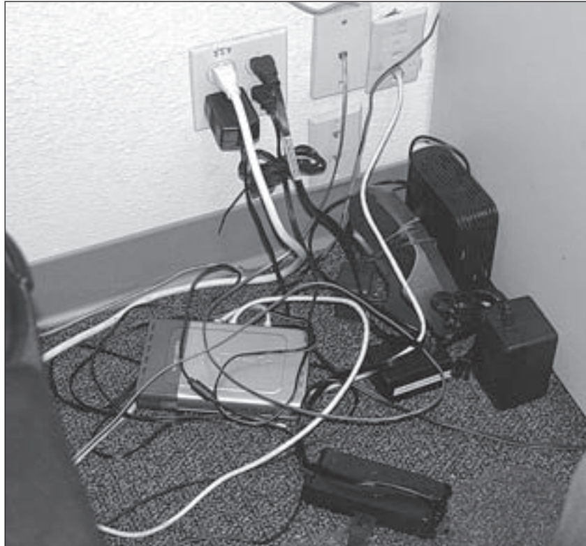
Foto B. Casi todo el mundo puede ver aquí alguna fuente de interferencia conducida por cable, pues hay varias fuentes posibles, entre las cuales vemos un calefactor con ventilador y una fuente de alimentación conmutada de ordenador.
