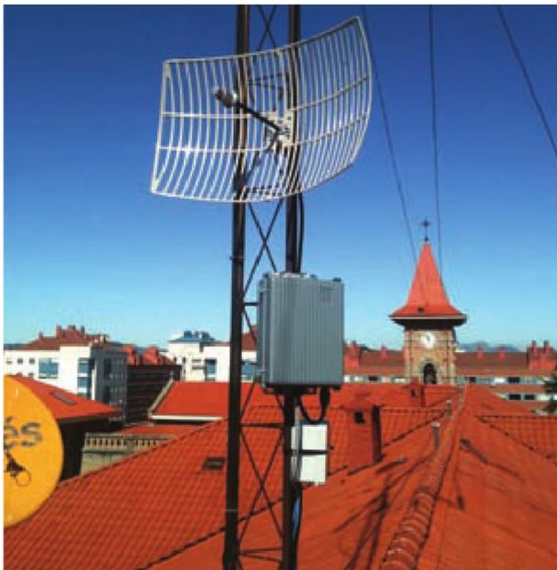
Instalación en la sede del Radioclub Foronda en Vitoria-Gasteiz
