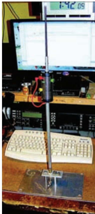
Foto C: La instalación de la antena de WOEB con una sola sección de mástil, la bobina, el extremo de látigo y la base (Foto cedida por WOEB)
