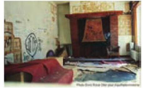
El locutorio de la chimenea en un estado lamentable.
