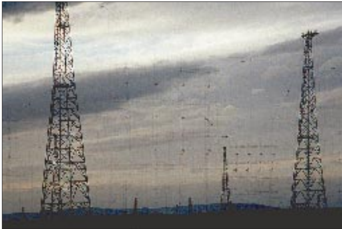
Tellansicht der Vorhangantennen in Emirler etwa 40 km südlich von Ankara – Standort eines 500-kW-SSB-Senders der „Stimme der Türkei“
