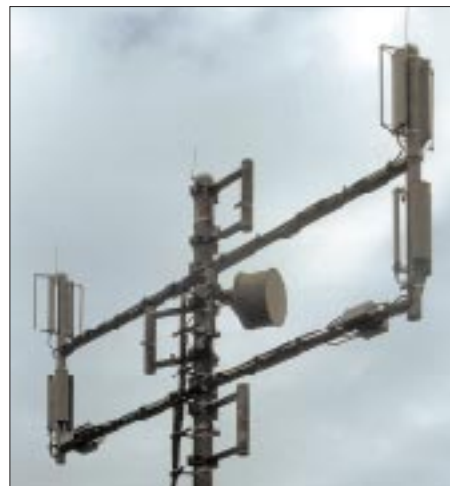
Kombinierte Antennenanlage einer Mobilfunk-Basisstation: GSM-Antennen und Richtfunkzuführung über RiFu-Antenne
