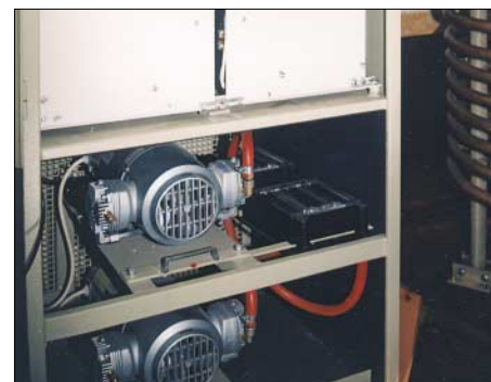
Kompressoren und Lufttrockner für die Koaxial-Speiseleitung Fotos: DL6AKC
