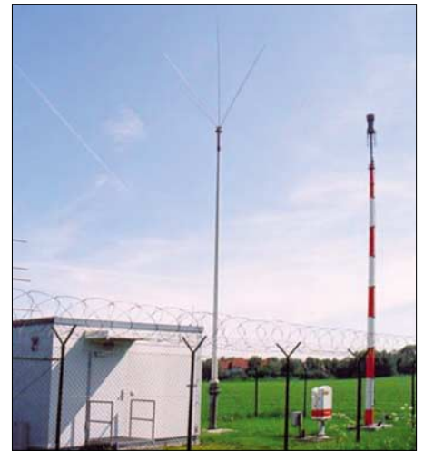
Sendecontainer und Antennenanlage der NDB ERT
