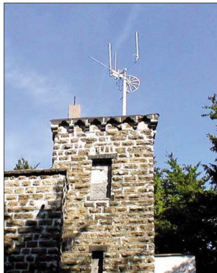
Die Antennenanlage des Digipeaters DB0MYK (Kreis Mayen-Koblenz) in der Vulkaneifel
