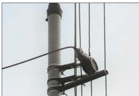
Bild 12: Detailansicht des 1:1-Baluns an der Einspeisestelle am 20-m-Element
