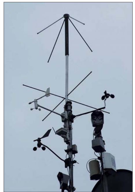
Bild 3: Blick auf den Mast mit Anemometer, Böenmesser und Wetterkameras
