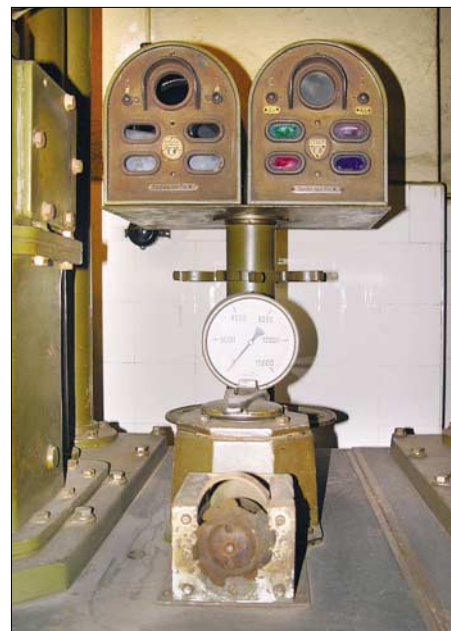
Bild 6: Rohrpost-Büchsenzählwerk und Luftstromanzeiger (Steuerungsanzeige), 1929
