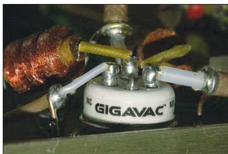
Bild 6: Fixer Bursche: Vakuumrelais von Gigavac, standesgemäß mit Teflonkabel verdrahtet
