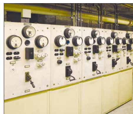
Bild 10: Noch erhaltene Rohrpost-Schalttafeln im Keller des ehemaligen Haupttelegrafenamtes in der Oranienburger Straße Foto: Stefan Lehmann
