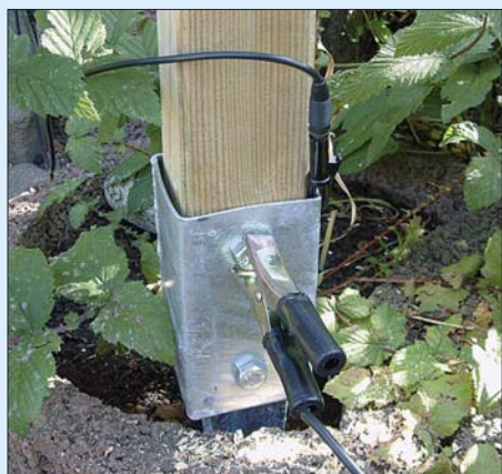
Bild 9: Zusätzliche Erdung an einer vorhandenen Einschlaghülse
