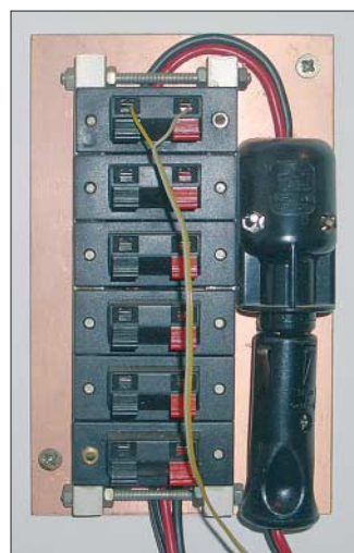
Bild 1: 13,8-V- Verteilung, an der Wand befestigt
