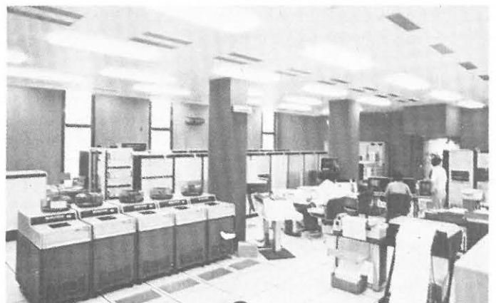
Centre de traitement du Service Argos à Toulouse.
