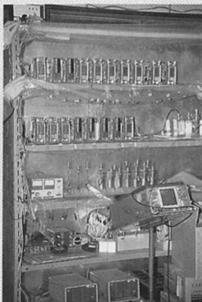
Armoire de mise en chauffe
