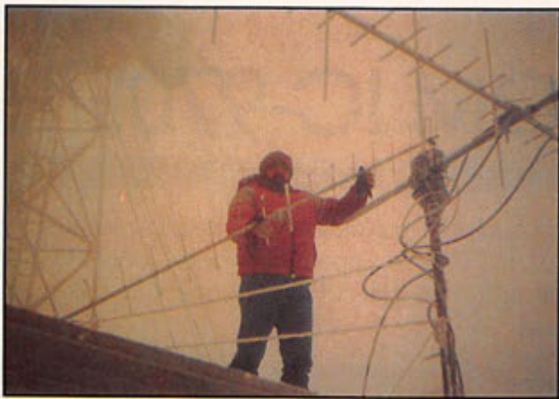
Dimanche 15 à 09h00. F1ONG démonte les antennes en pleine tempête. Remarquer le givre sur les éléments et cables.
