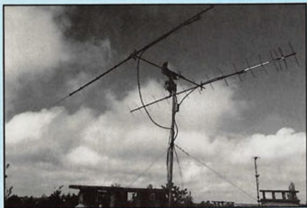
F1OK : les antennes.
