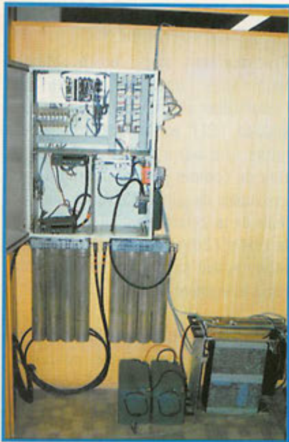
L'armoire avec ses émetteurs, cavités, logique, et alimentation de secours.
