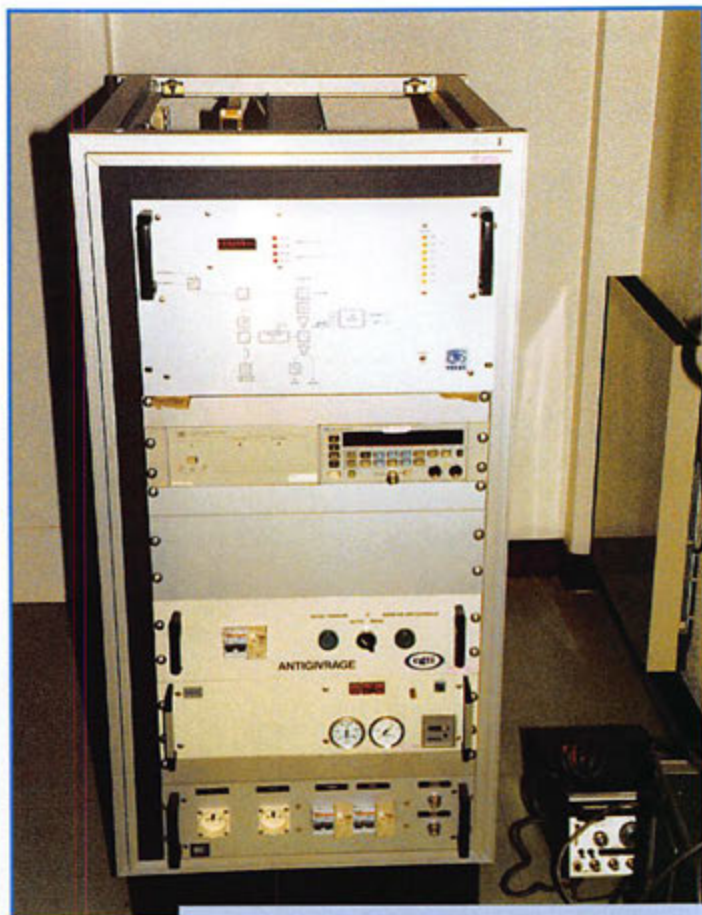
6. Baie de mesure des canaux de TdF1.
