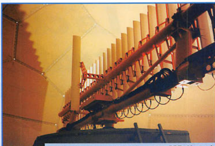
Vue sous son radôme, l'antenne SSR. Un seul doublet à l'arrière pour la suppression des parasites. L'antenne mesure 12m x 1m !
