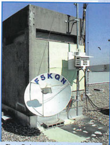
Photo 7 - La parabole de réception Meteosat et la station de mesures météo.
