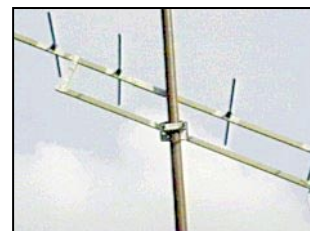
Antenne Yagi levée à 45°.
