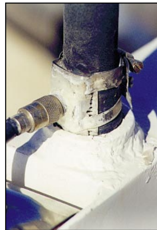
La base du fouet montrant le morceau de collier inox assurant la mise à la masse de la fiche.
