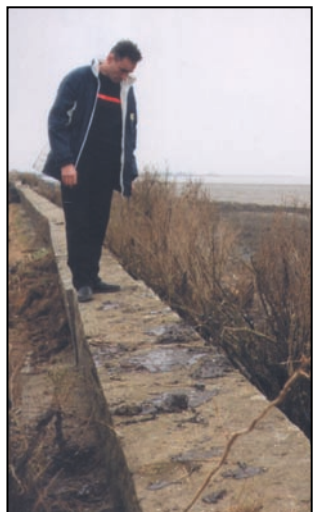
Constatation des dégâts par F5NZN.
