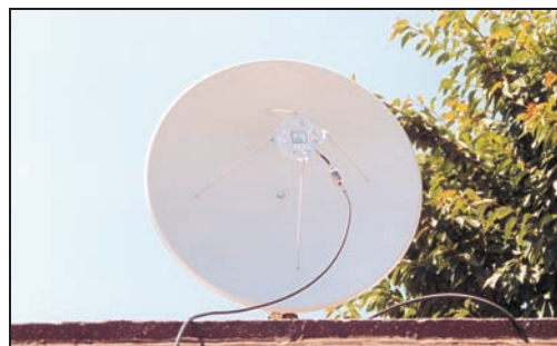
Photo 12 : LNBY monté au foyer d'une parabole. On remarque l'ampli de ligne BIS.
