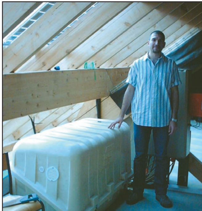
3 - Le propriétaire de l'installation devant le compartiment "batteries".
