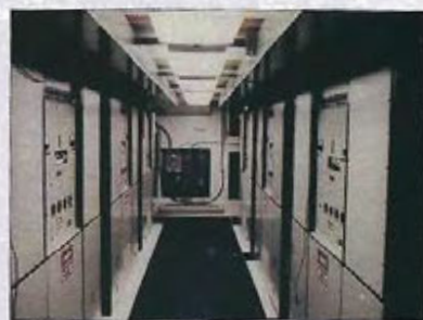
4 - Une vue de l'intérieur des installations.
