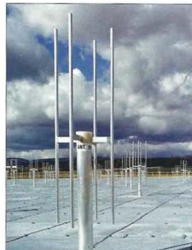
4 - Détail d'un des groupements d'antennes de réception.
