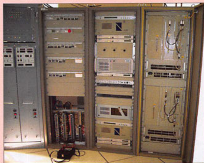
5 - À g. les deux baies de l'ancien radar secondaire mono-impulsion de Montpellier, et à d. le nouveau, Mode S, "CIRIUS" fabriqué par Thalès.
