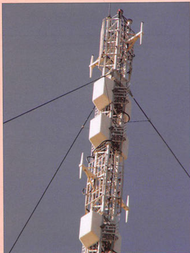
4 - Pour chaque fréquence d'émission, deux antennes panneau, placées dos à dos, assurent une couverture de 360 degrés.
