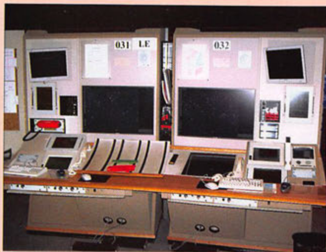
6 - Pupitres d'un contrôleur aérien du secteur LE (Lyon-Est) de la FIR Marseille: un écran principal, d'autres de commande ou d'information; les supports rouges et verts sont destinés à recevoir le "strip", la fiche de chaque avion avec son immatriculation, son N° de vol, sa route, etc.) La couleur du support a une importance: rouge la route est vers le nord, vert vers le sud. Au sol les pédales de commande d'émission radio.
