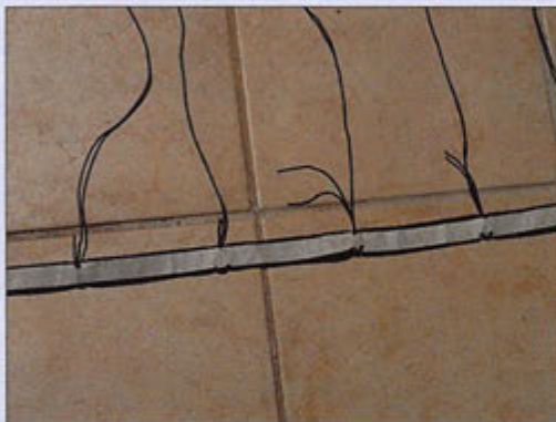
6 - Vue la boucle de finition avant mise sous tension.
