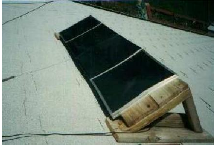
Panel solar en el techo
