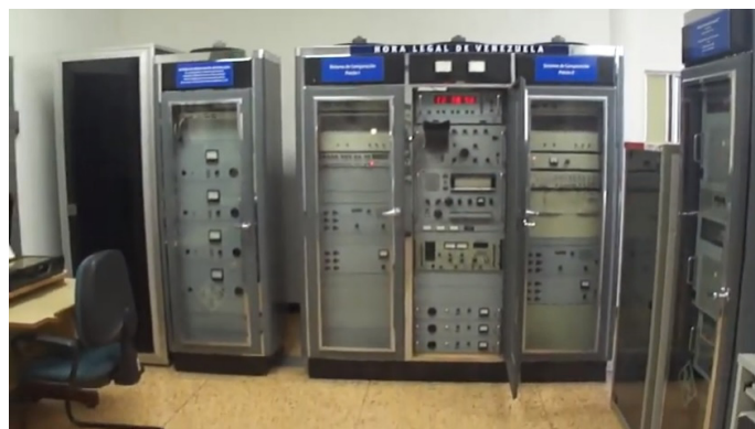
Aqui podemos ver à esquerda o primeiro rack que contém o sistema de unidade digital internada, que permite a comunicação entre o prédio do NEA da Cantv e o observatório naval de Cagigal, para a transmissão diária do horário do número de telefone 119.
