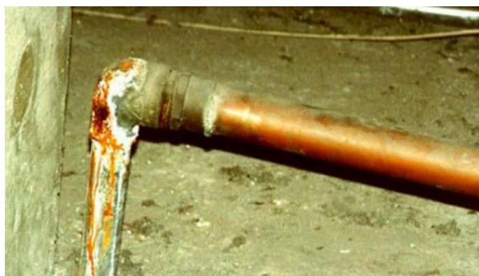
2 - Corrosão no tubo de aço galvanizado ligado a um tubo de cobre.
