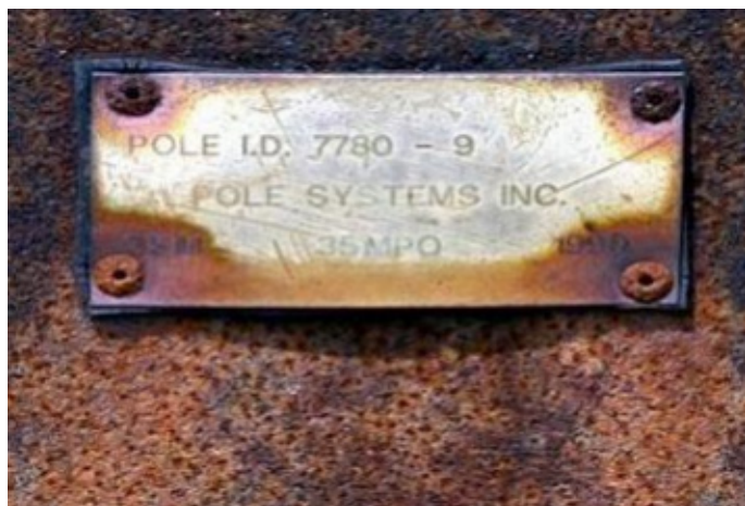
1 - Corrosão nos parafusos de aço que fixa a placa de latão.
