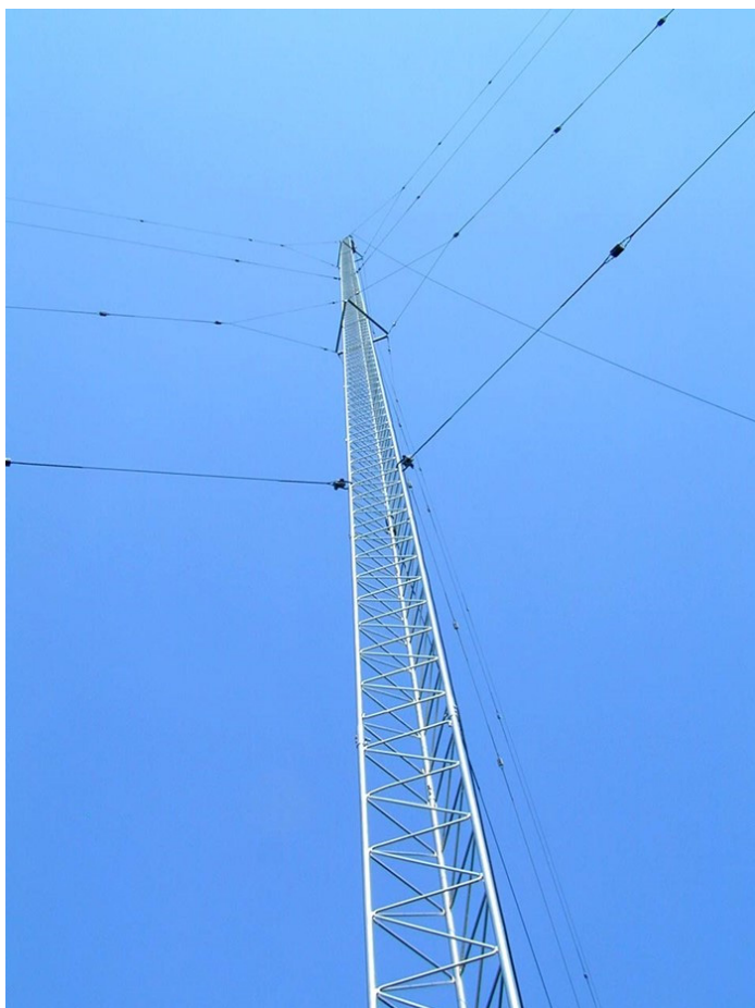
36 - Estais seccionados e dispositivo anti-torção.
