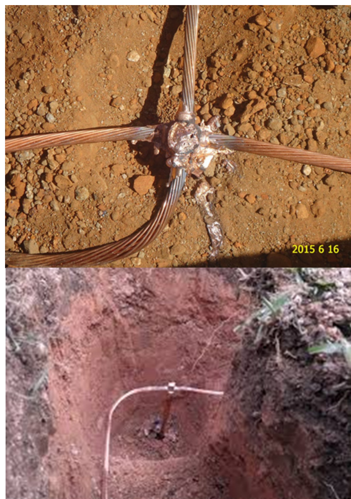
38 - Exemplos de solda exotérmica de cabos com hastes
