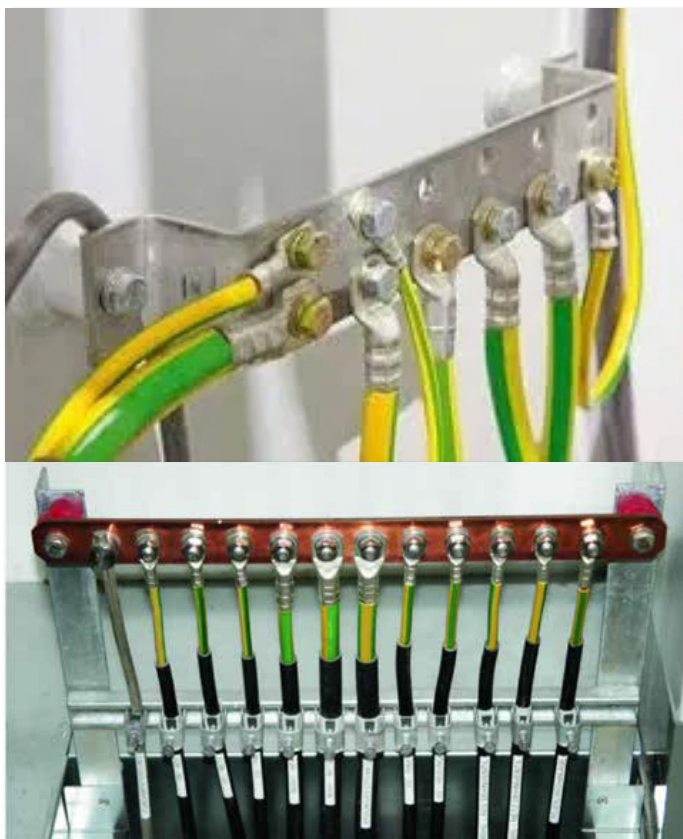
27 – Barramento de equipotencialização
