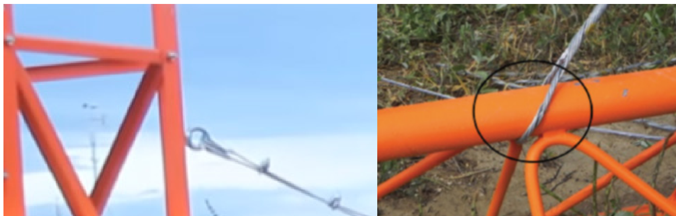
12 - Forma incorreta de fixação do estai na torre.
