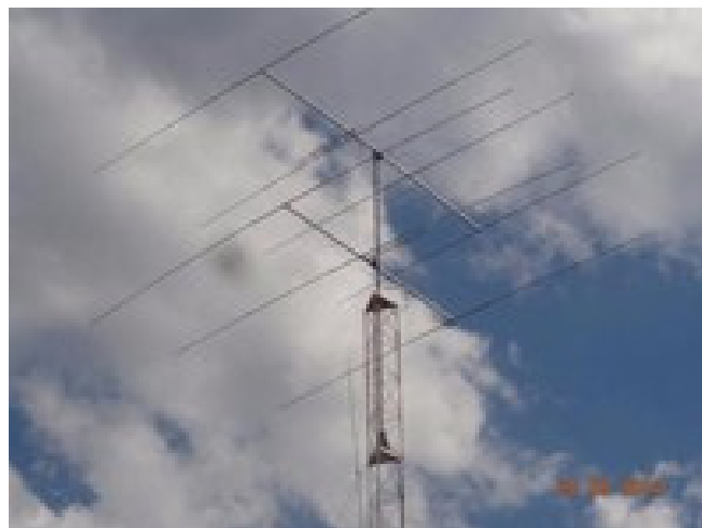
4 - Torre com duas antenas tipo Yagi.
