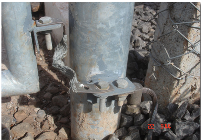
3 - Aterramento de um portão metálico em uma subestação
