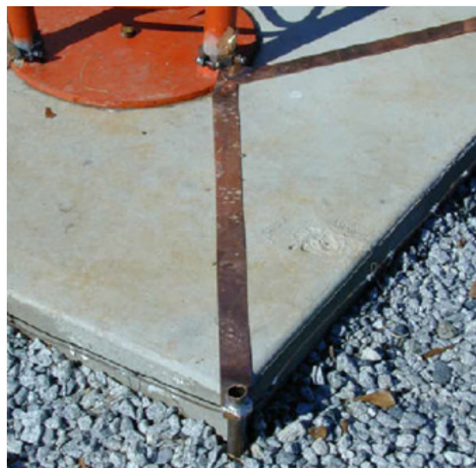
61 – Aterramento dos estais
