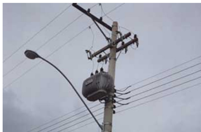
8 - Os três condutores que estão na cruzeta, em posição horizontal são da linha de média tensão e os cinco condutores presos no "rack" na posição vertical são da linha de baixa tensão (3 fases, 1 neutro e 1 da alimentação da luminária).
