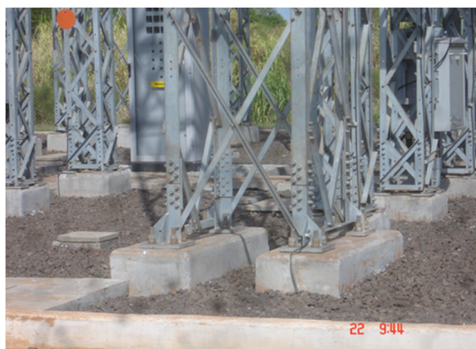
2 - Aterramento de uma torre do barramento de uma subestação.
