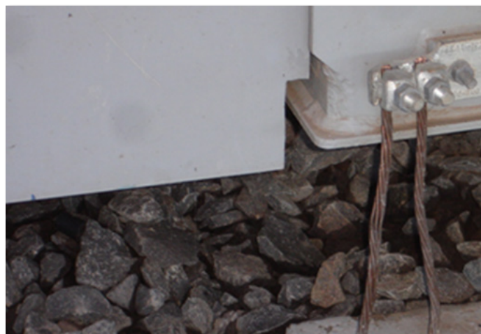
1 - Aterramento da carcaça de um transformador em usina hidrelétrica.
