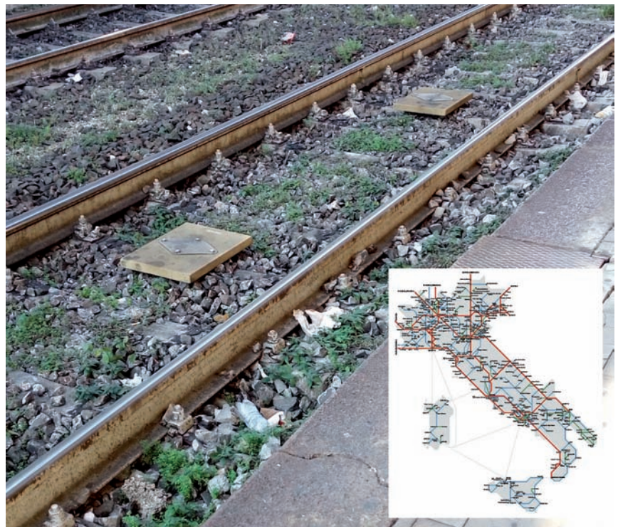
Fig. 3 - La foto mostra come appaiono tipicamente le boe, in questo caso una coppia installata nel medesimo binario serve a formare un punto informativo (PI). Nel riquadro l'estensione della rete ferroviaria nel nostro Paese, a colpo d'occhio si coglie anche la diffusione generale di questa tecnologia.
