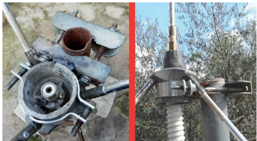
Fig. 11 - Foto della staffa di ancoraggio installata
