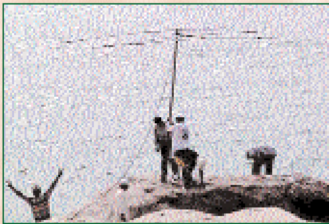
Instalación de la Cushcraft MA5B, tras perforar la estructura de granito para introducir clavijas que la sostuvieran. Aguantó bien el viento los dos días.
