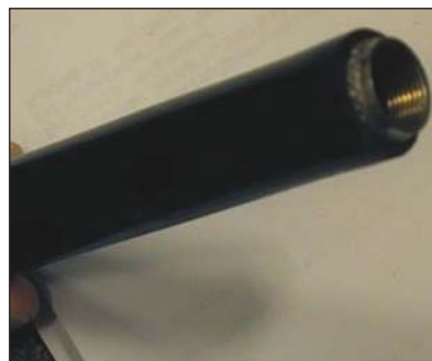
Foto 7: Detalle de la base de la antena montada, PL embutido en aislante eléctrico.
