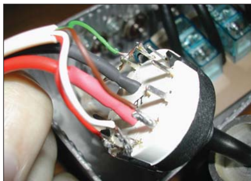
Foto 4: Detalle del conmutador de control, al centro llegan el vivo y la masa de la fuente, el vivo es conmutado a cada cable de subida y la masa es común (cable verde en la foto).
