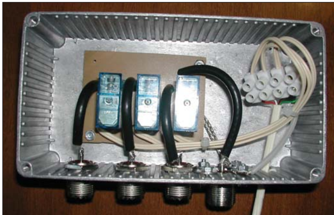
Foto 1: Conmutador finalizado y listo para operar. Si el lector sigue atentamente el artículo, éste será el resultado, a falta únicamente de colocar la tapa.
