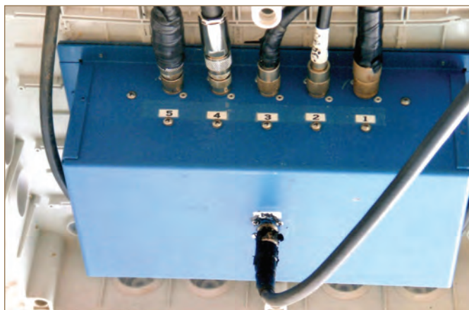
Foto 3 . Conmutador coaxial remoto
