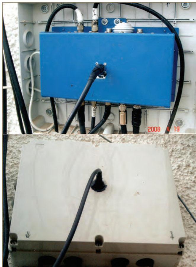
Foto 5. Conmutador remoto de antenas protegido herméticamente.
